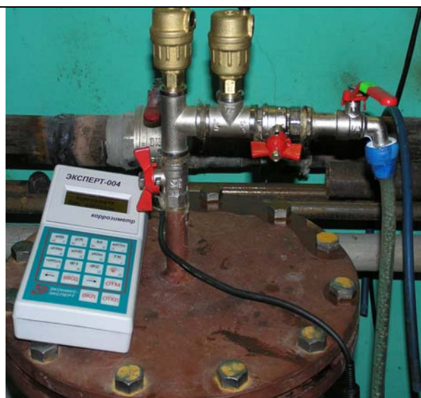
Коррозионный мониторинг сетевой воды в городской котельной с использованием коррозиметра «Эксперт-004»
